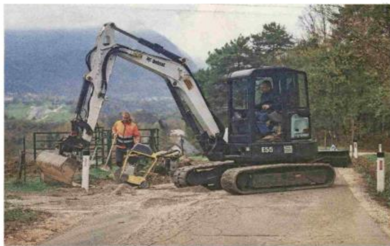
Vodovodni sistem Završnica je dotrajan, s posodobitvijo in nadgradnjo bodo izboljšali oskrbo z vodo. / Foto: Nik Bertonec
