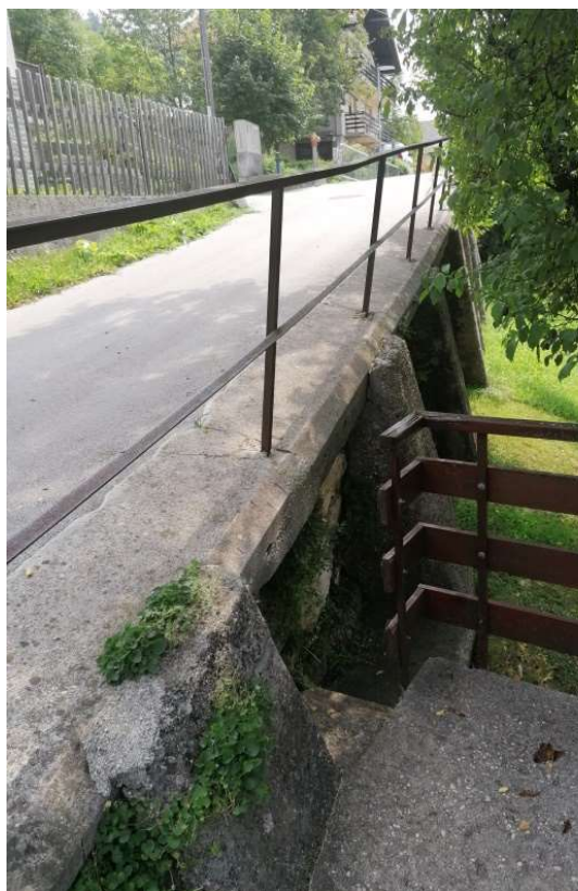
NAGIBAJOČ OPORNI ZID V ŽIROVNICI
