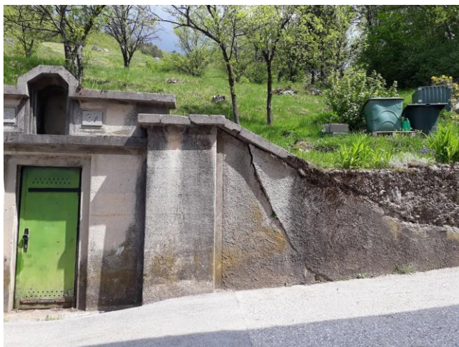
Razpokan oporni zid južno od vodohrana
