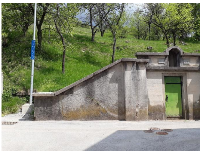
Razpokan in zarotiran oporni zid severno od vodohrana
