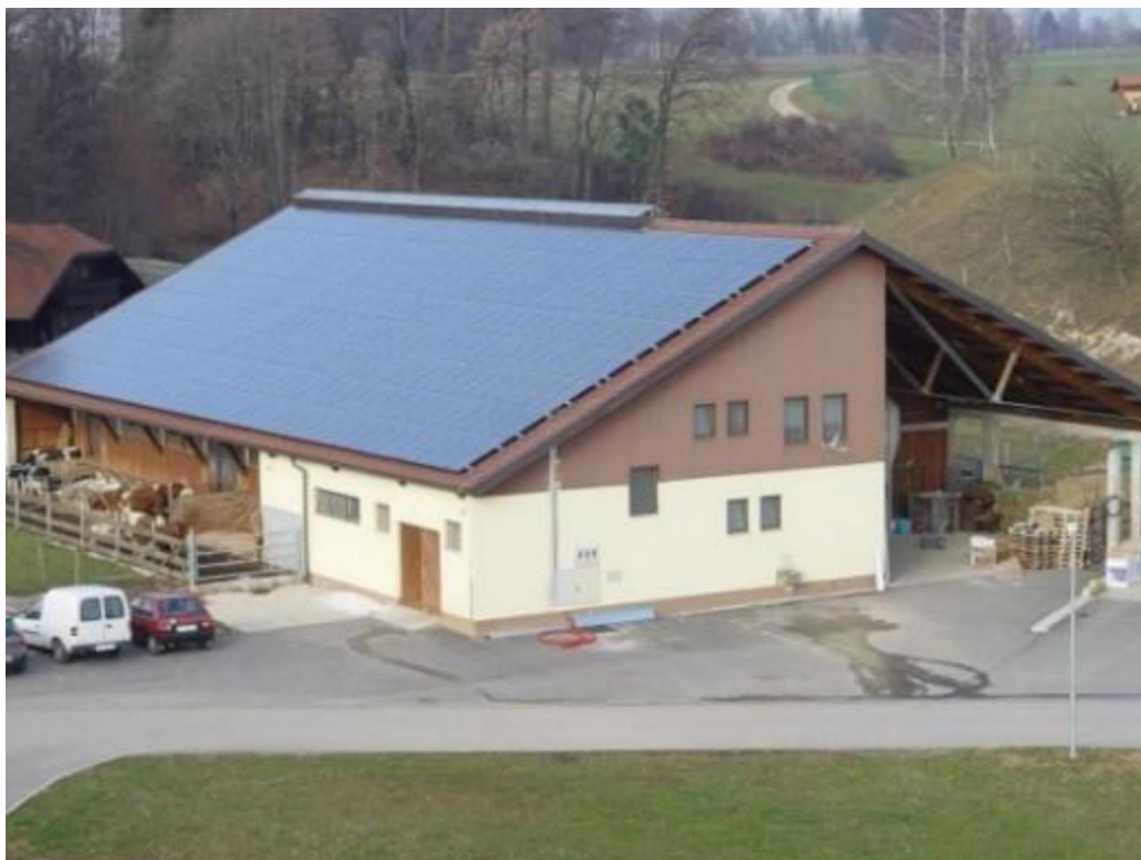
Slika 11-11: Sončna elektrarna na strehi objekta
