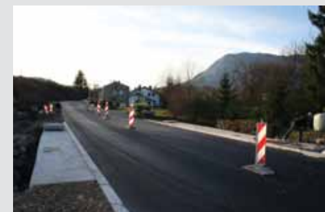
→ Pot na Poljane Zaključena je rekonstrukcija ulice Pot na poljane v delu od Ljubljanske ceste do mesnice Dolmes. V okviru investicije je bila v celoti prenovljena vsa infrastruktura in izvedena preplastitev ceste.
