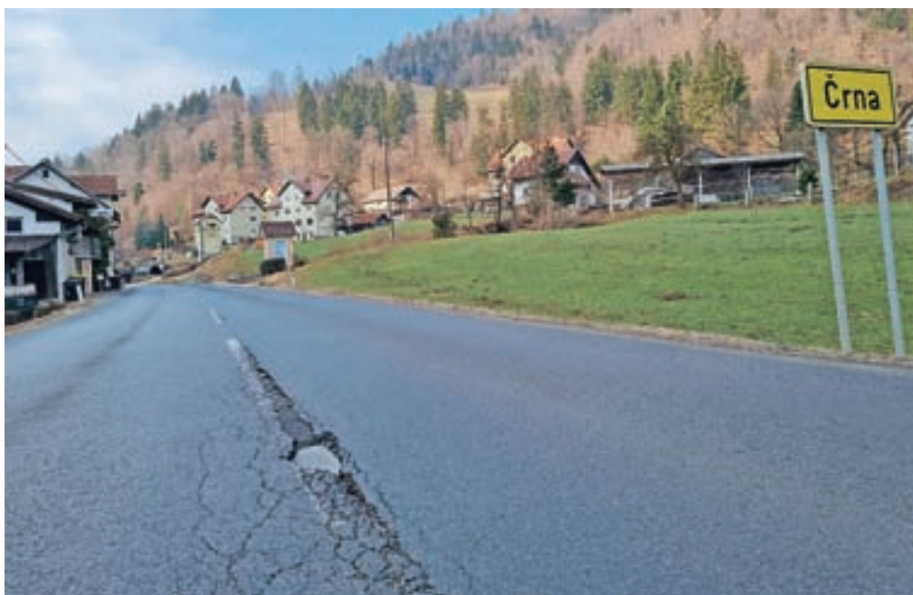
V Črni bodo še do poletja dobili nov asfalt – pa tudi kanalizacijo. / FOTO: JASNA PALADIN
