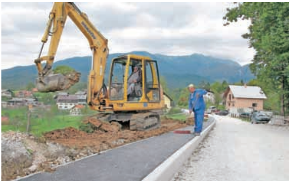
Na območju Tunjic, kjer je bilo težav tudi zaradi oviranja prometa največ, je bilo do sedaj zgrajenih šest kilometrov kanalizacije. / FOTO: GORAZD KAVČIČ
