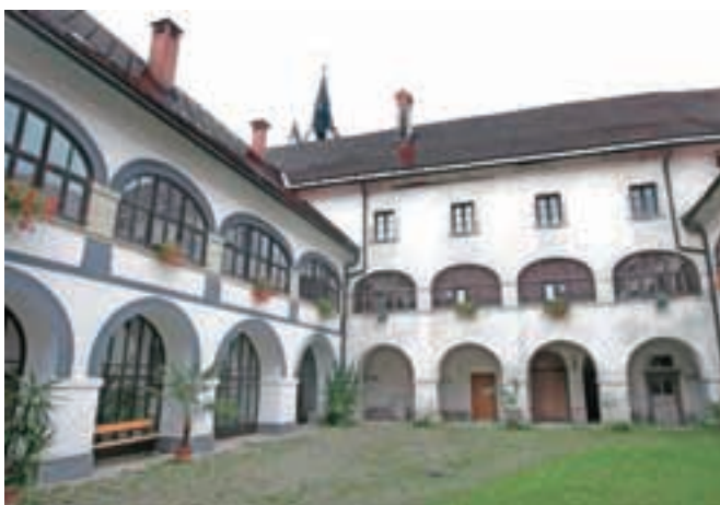
Mekinjski samostan je delno obnovljen, velik del pa je še vedno v slabem stanju. / FOTO: GORAZD KAVČIČ
