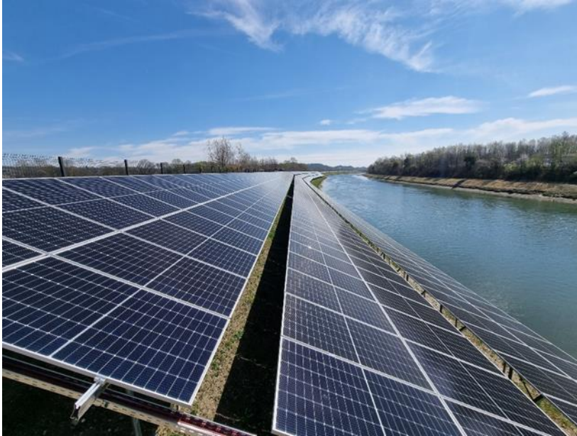
Segment pet Sončne elektrarne Zlatoličje; foto: Arhiv DEM
