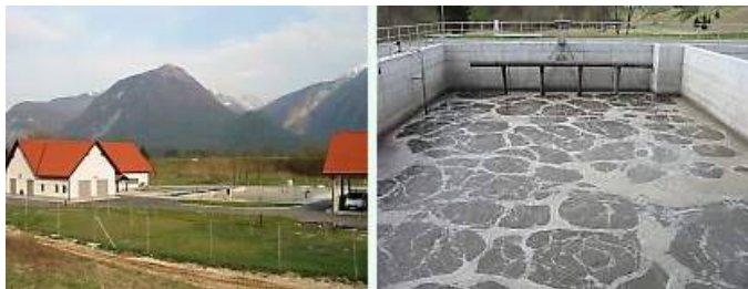
Slika 27: Čistilna naprava Bovec (Komunala Tolmin, 2011)
