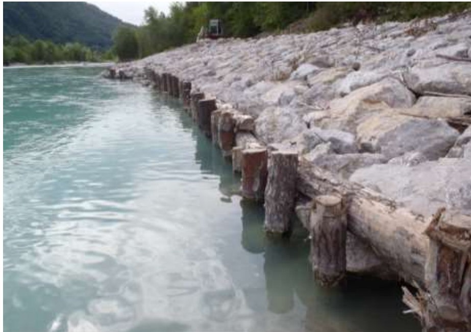
Slika 3: Primer izgleda podpore konstrukcije ob visoki vodi Soče – 2,0 m nad normalni pomladni vodostaj (130 cm in pretok 33m 3 /s) pri vodometri postaji Log Čezsoški (vijačenje spojev med lesnimi elementi na sliki ni izvedeno pravilno).
